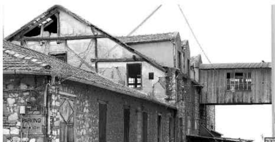
☉ Πλευρική άποψη από την οδό Αστιγγος. Διακρίνεται ο τρόπος δόμησης με παραδοσιακά υλικά και μεθόδους
